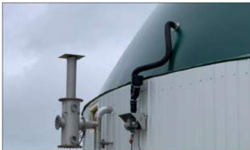
Ilustración 8. Válvula de sobrepresión y soplane de aire instaladas en reactor. AGF.
