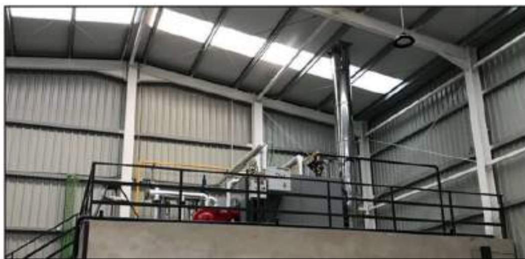
Ilustración 3. Ejemplo de sala de calderas diseñada y construida por AGF para una planta de biometano.
