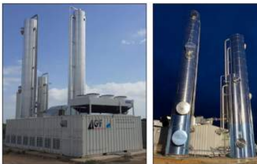
Ilustración 13. Planta de Biometano Comprimido para logística de gaseoducto real.
