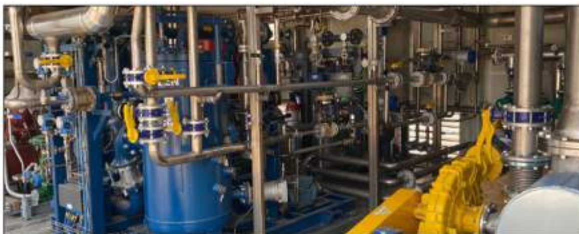
Ilustración 15. Ejemplo de sala de equipos de planta de biometano comprimido AGF.
