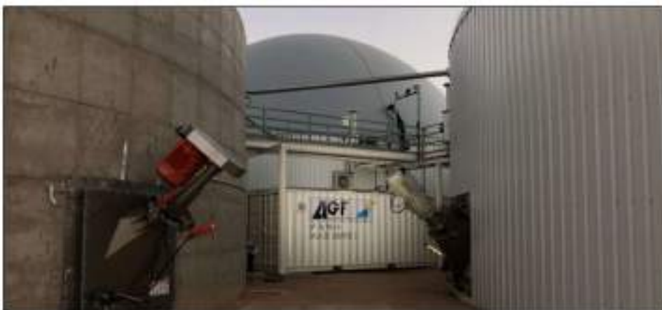
Ilustración 11. Sala de equipos 2 (SE-2), situada entre reactores. Tecnología AGF.
