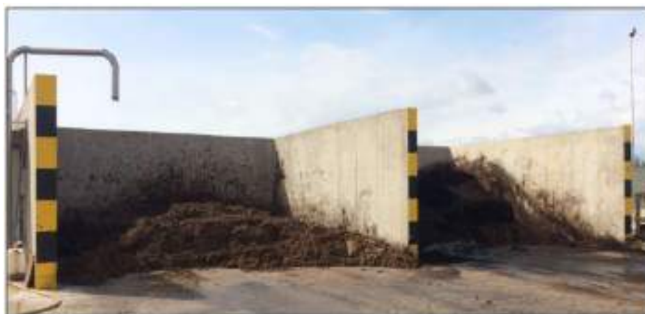
Ilustración 5. Ejemplo de silos para descarga de material externo. Fuente: AGF.
