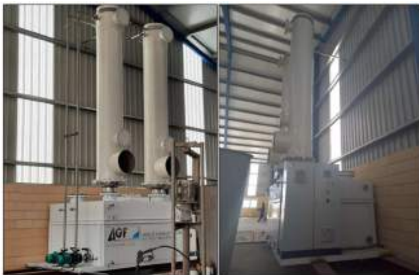
Ilustración 6. Unidad de eliminación de olores durante fase de montaje. Modelo AGF.
